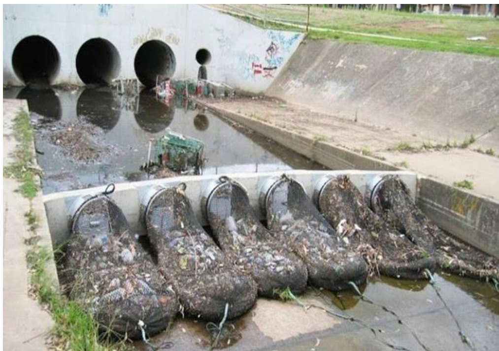
Рис. 3. Сетка на выходе дренажных труб
