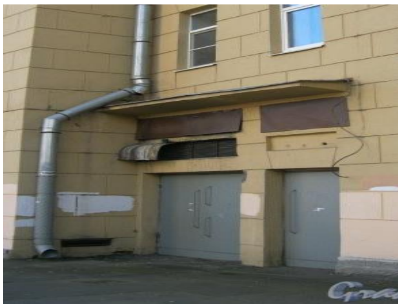
Рис. 2. Встроенная трансформаторная подстанция в жилой дом
