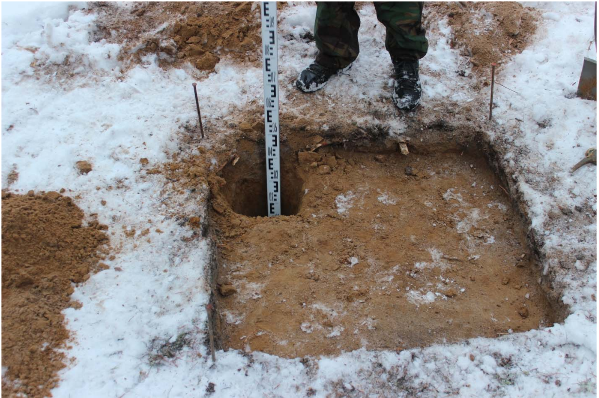
Илл. 19. Объект «Установка дополнительного АВО газа на КС «Портовая». Шурф 2. Контрольный прокоп, вид с севера, для масштаба использована рейка длиной 1 м.
